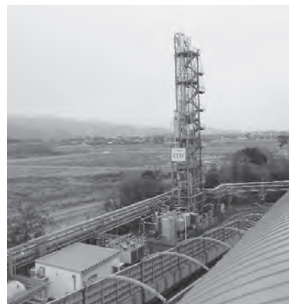
写真 二酸化炭素分離回収設備
