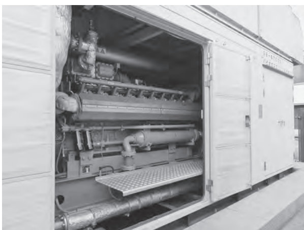
写真2 ガスエンジン発電機
