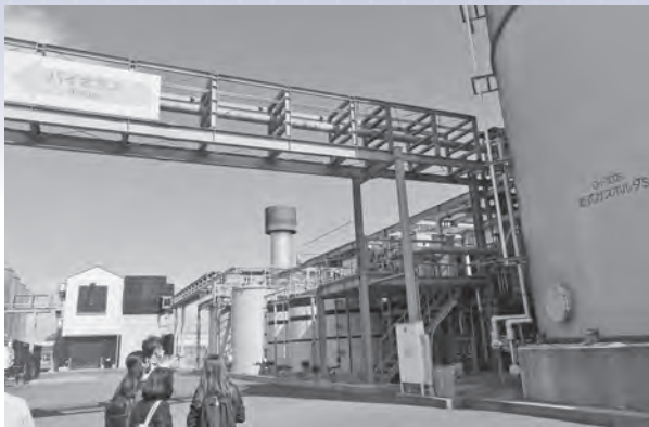
写真1 中央：バイオガスを製造工程へ供給、右：ガスホルダ
