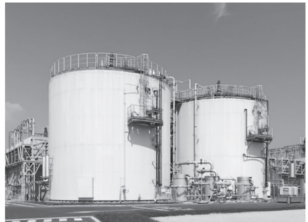
写真2 メタン発酵槽外観
