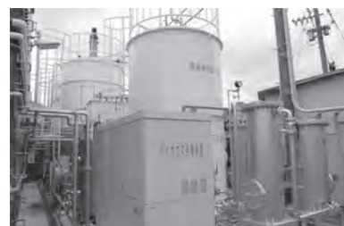
写真2 ガス貯留槽(中央の円筒)、バイオガス発電装置(手前)
