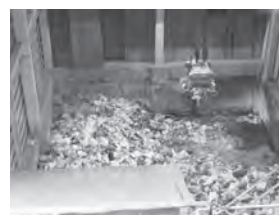
写真3 一般化燃ごみ受入ピット
