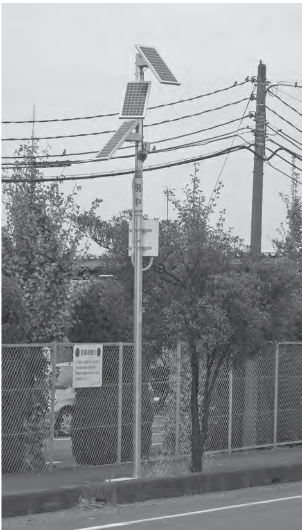
図2 監視カメラの設置
