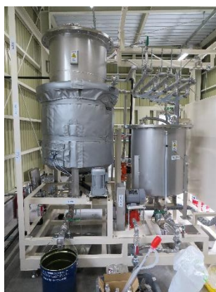
減圧蒸留装置
