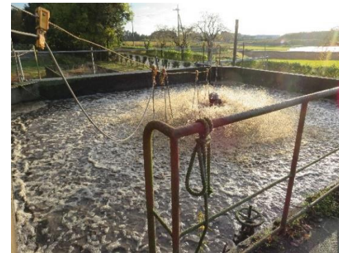
養豚農家が設置する 排水処理設備
